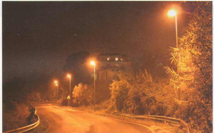
Fig 4. Lo stesso impianto con i vetri piani al posto delle coppe curve (altro tratto di strada).
